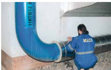
ORSTECH LSP H lamellázott matrac nagyobb átmérőjű csővezetékén.
