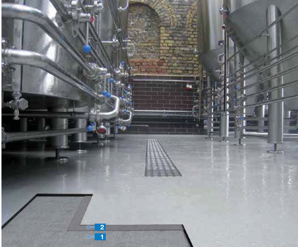
Poliuretán-cement nagy terhelhetőségű iparipadló rendszer
