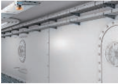
A kábelbandázs alkalmazása agresszív környezetben, pl. tengeren
