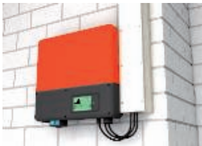
Az érintésvédelem közvetlenül az invertertől indul
