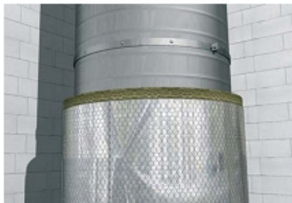
A szigetelőpaplan könnyen, kivágások nélkül beborítja a légcsatorna illesztéseit és a tartókonzolokat.
